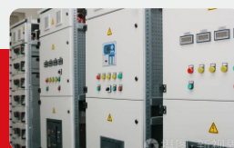
配电设备状态监控
